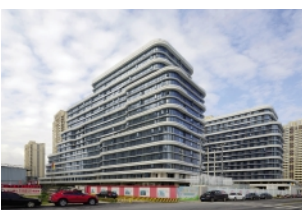
作为嘉兴港区重大民生工程之一，博元集团高度重视项目建设工作。自2019年12月14日开工建设以来，项目部按照“百日攻坚战”的要求，合理作业，科学施工，克服疫情影响，加班加点提前完成项目
