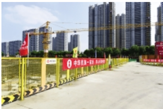
基坑临边防护
