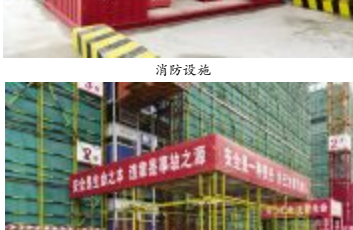
施工升降机防护棚
