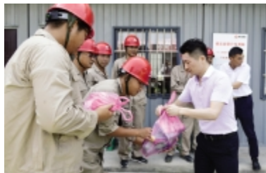
持续的高温“烤验”着项目部一线员工,但他们依然不下“火线”,坚守在各自的工作岗位上。7月26日上午,公司生产副总裁钱
