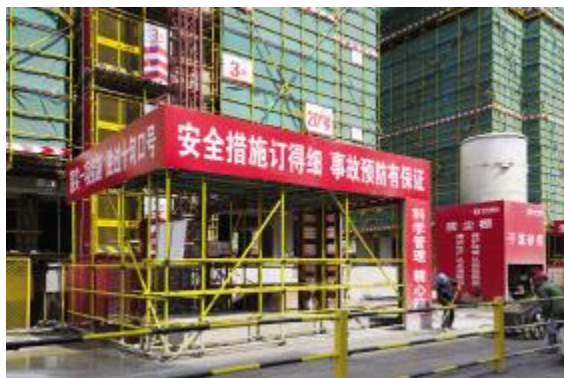
施工升降机防护棚
