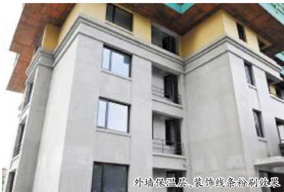
主楼外墙装饰施工阶段,地下室已经施工完成,沿街商铺已交付使用
