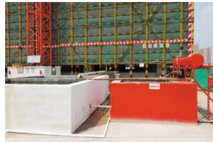
雨水回收池,作临时消防用水
